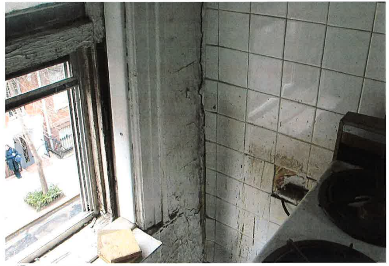
7 PLASTER DETERIORATION (INTERIOR SOUTH WALL) SCALE: N.T.S. A-5
